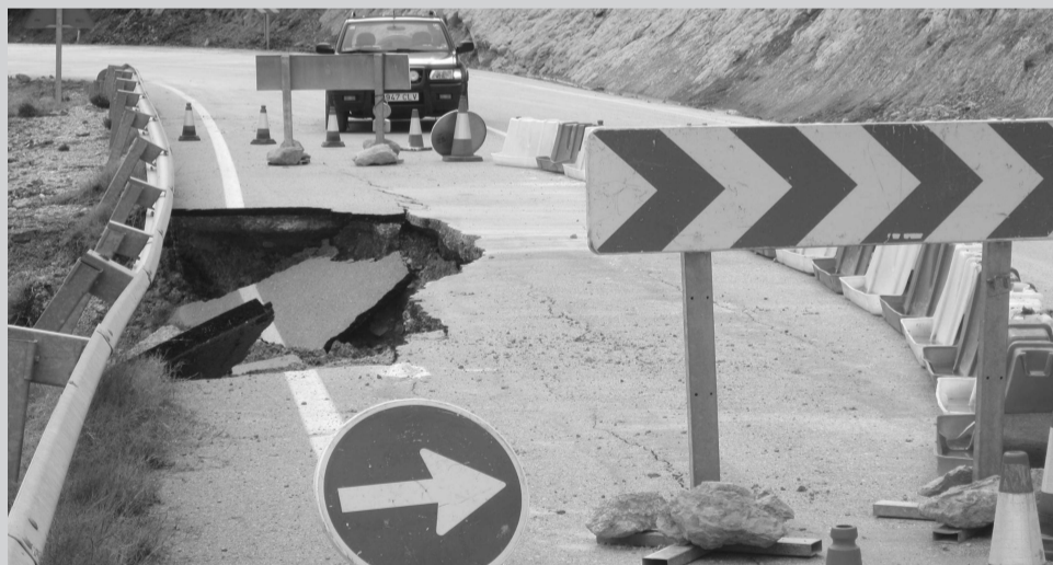
Hundimiento de la carretera en el término municipal de Bordón.
