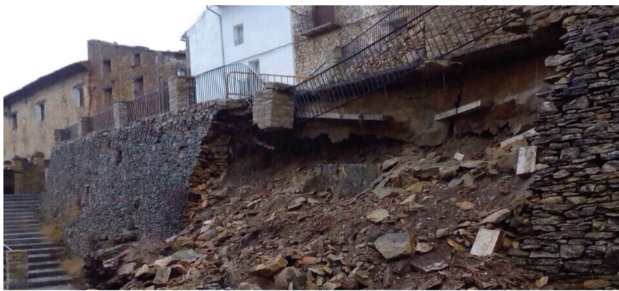
Desprendimientos en La Iglesuela del Cid a causa del fuerte temporal.
